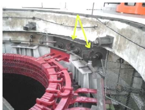
Fig. 6 Amplasarea cuplurilor la ieșirea din generator (montaj DIR, se observă pe interior doar un set de 3 cupluri) - CHE Mărișelu
