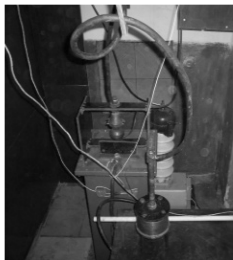
Fig. 2. Vedere generală a instalației.
