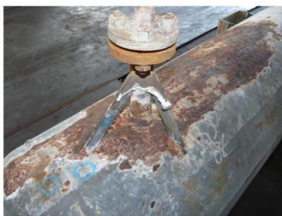
Рис. 2. Разрушение цинкового покрытия оборудования в следствии КПИ. 4
