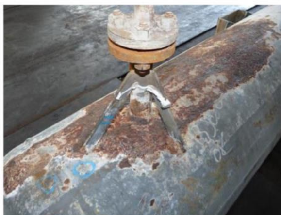
Рис. 2. Разрушение цинкового покрытия оборудования в следствии КПИ. 4
