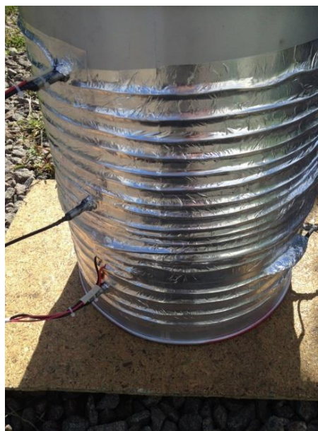
Рис. 2. Электрический нагревательный кабель, уложенный на наружную стенку биогазового реактора. 2
