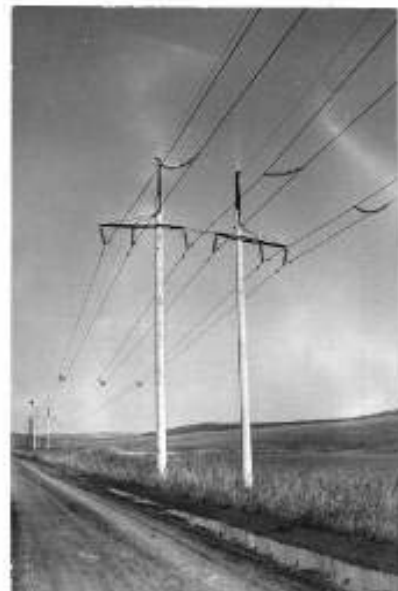
Рис. 7. Опытно-промышленная УСВЛ-110 кВ в Молдавской энергосистеме.
