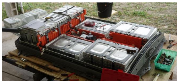
Рис. 4. Внешний вид исследуемого блока модулей аккумуляторной батареи электромобиля Nissan Leaf.
