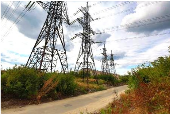
Рис. 2. Группа высоковольтных линий электропередач. 2
